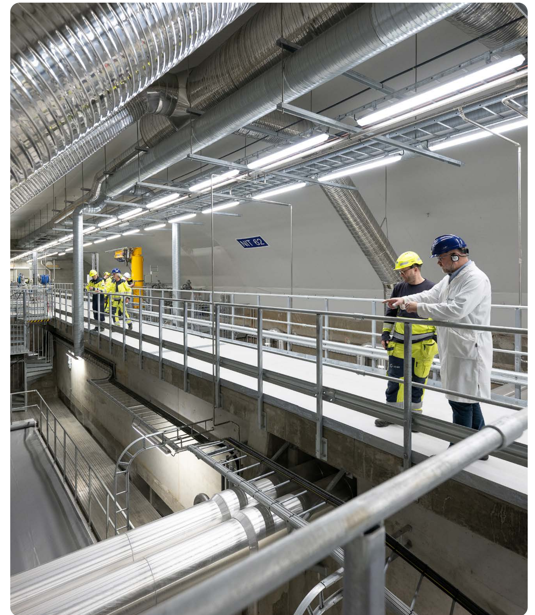
I 2022 ble prosesshall 5 og 6 satt i drift slik at vi nå totalt har åtte prosesshaller og økt total nitrogenfjerningskapasitet. Renseresultatene i 2022 var gode; 74 prosent av tilført nitrogen ble fjernet. Kravet er 70 prosent.
